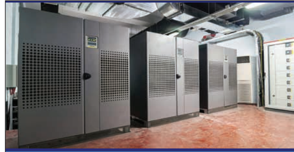
تامین دهها دستگاه UPS و بیش از ۵ هزار بلوک باتری جدید برای مقاوم سازی ارتباطات کشور در مقابل قطع برق
